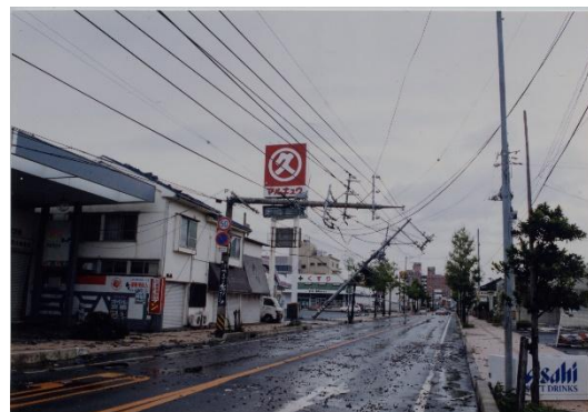
平成 11 年台風第 18 号 (竜巻被害)
