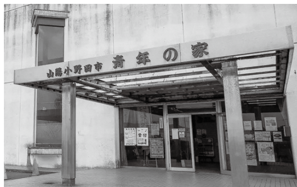
管理棟玄関の屋根も崩れている状況
