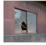
窓が割れた管理不全空家
