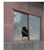
窓が割れた 管理不全空家
