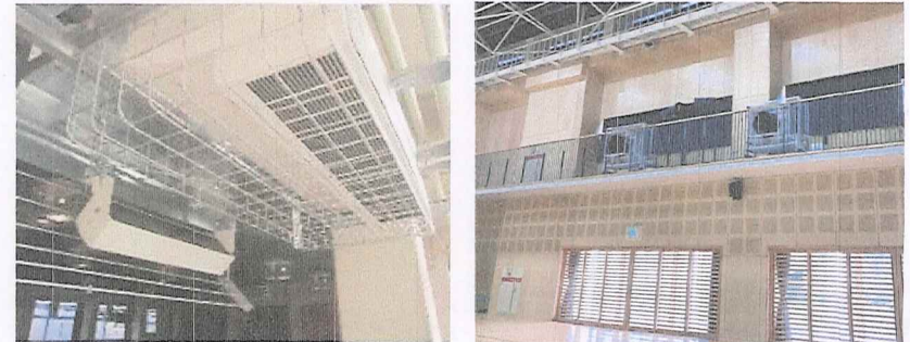
災害時にも利用可能な学校体育館の空調設備
