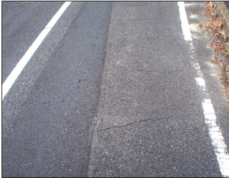
ひび割れ 40%程度の例
