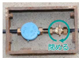
▲メーターボックス(左:メーター 右:止水栓)
