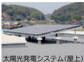
太陽光発電システム(屋上)
