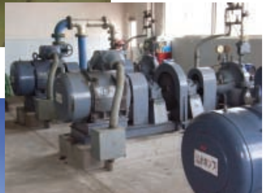
そう すい しつ ● 送水ポンプ室
