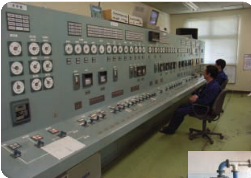
ちゅう おう かん し しつ ● 中央監視室
