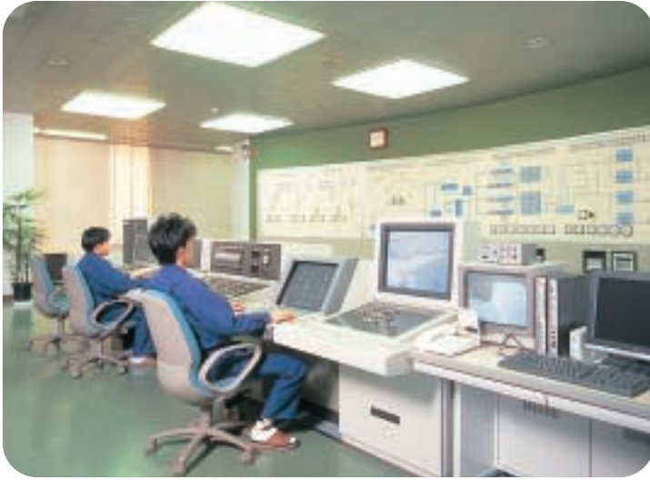
● 中央監視室 かんし
