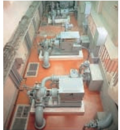
● 送水ポンプ室
