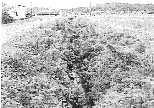
② 傾斜が厳しく足場がない
