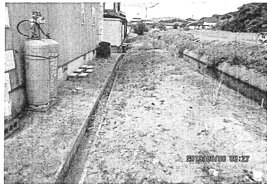
① 梅雨の大雨で浸水した箇所
