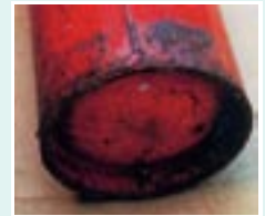
▲溶接部とその周辺の剥離
