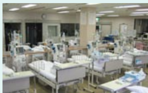
▲透析装置が設置された室内の様子
