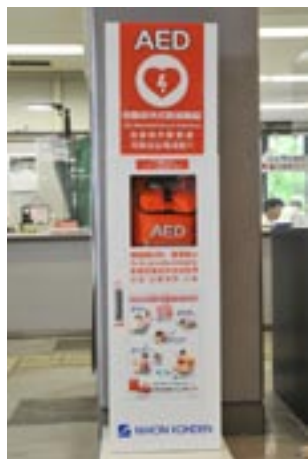
▲市役所に設置してある AED
