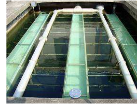
かち ろ過池 たかまがはらじょうすいじょう (高天原浄水場)
