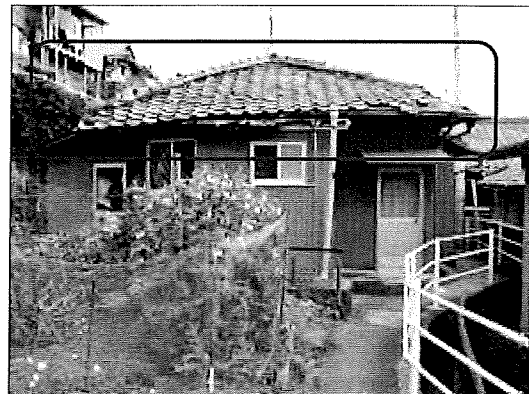
屋根に不陸がある例
