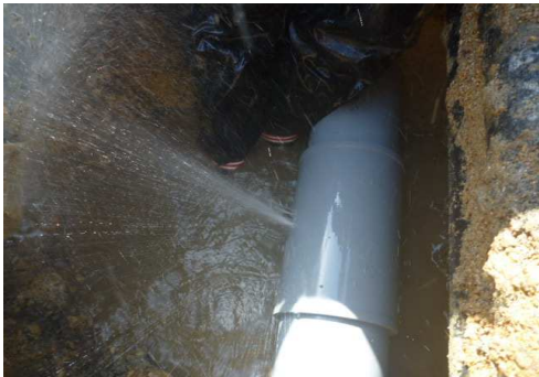
水道管（配水管）の継手部（ジョイント）より漏水している状況。 水道水が吹き出しています。
