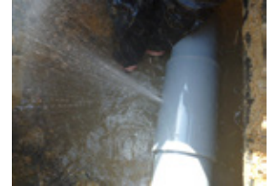
▲水道管の漏水
