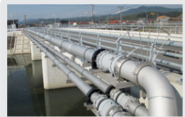
厚狭川新橋に架かる水道管 (平成25年8月完成)
