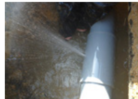
▲水道管の漏水
