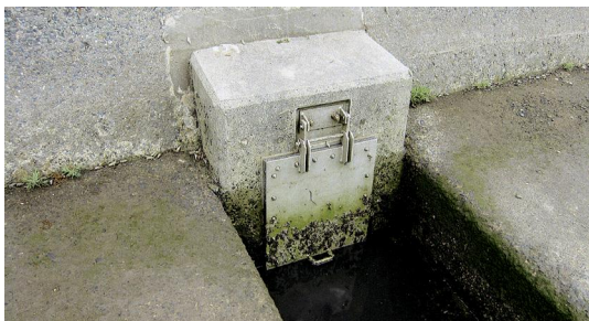
有帆川 出口排水ダンパー
