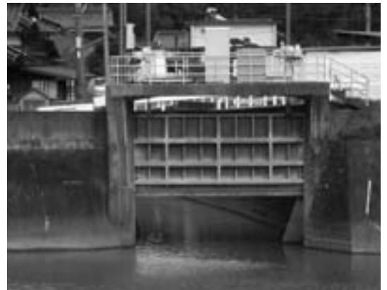
狭間川排水機（手前は厚狭川）
