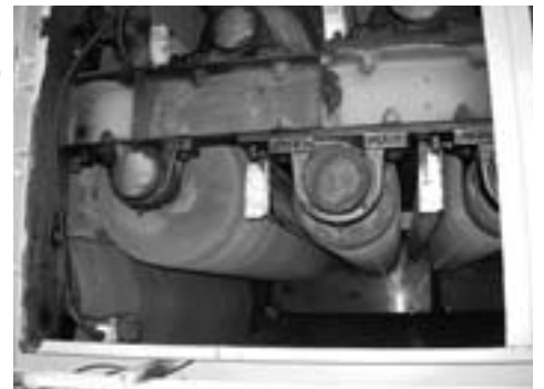
▲更新される汚泥脱水機(小野田浄化センター)
