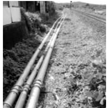
新橋崩落により仮配管された水道管
