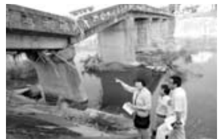
被災した厚狭川新橋
