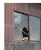
窓が割れた 管理不全空家
