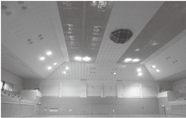
現在の市民体育館照明設備
