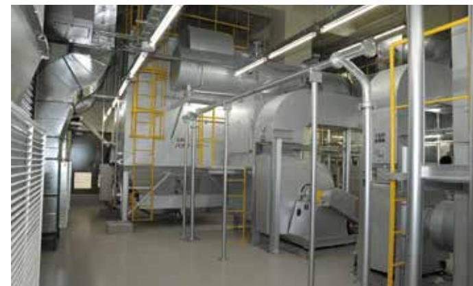
排ガス処理設備
