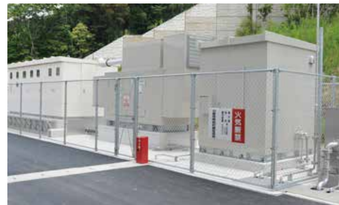
非常用発電設備
