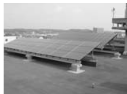
本庁舎屋上に設置された太陽光発電設備
